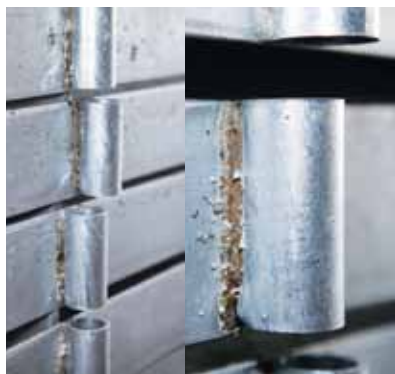
Не зачищенные сварные швы
